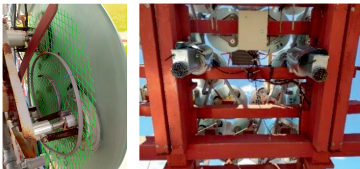
Рис. 6. Греющий кабель (слева) и тепловые пушки (справа)
